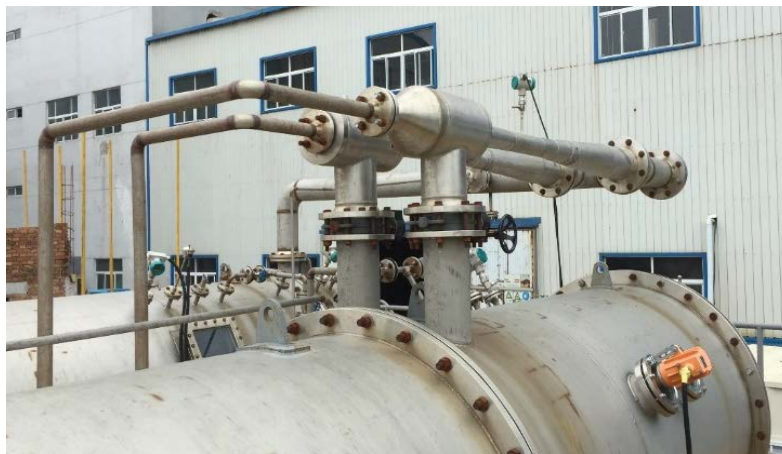
Fig. 14. Steam ejectors used in 50 m 3 d -1 MED pilot plant.
