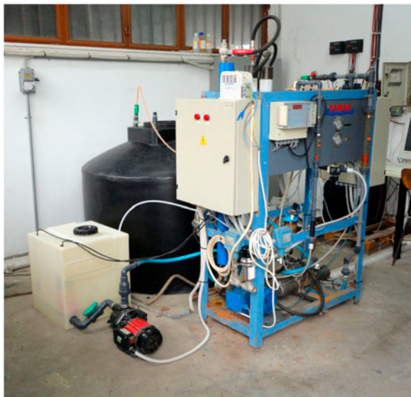
Fig. 2. RO desalination unit.
