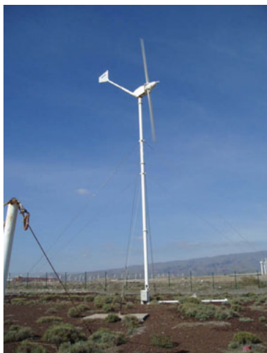
Fig. 5. 15 kW W/G, Pozo Izquierdo, Gran Canaria ITC, 2004.
